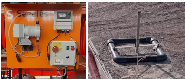
Figura 6. Panell equip dosificació i sistema flotant de mesura de pH a la bassa. Font: Mecàniques Segalés SL.
