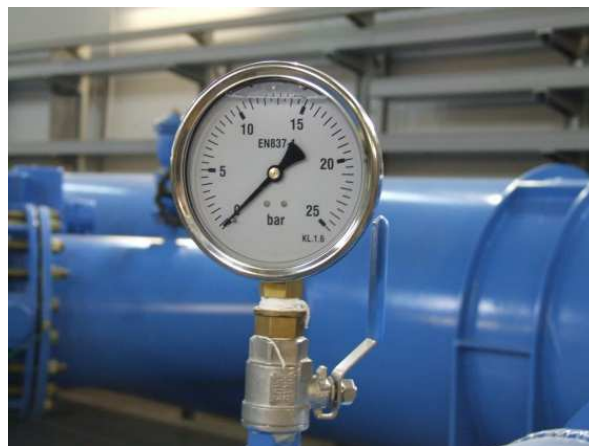
Foto 9. Detall d'un manòmetre
