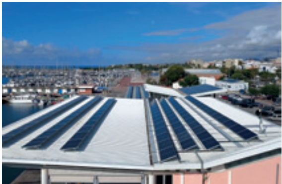
Detall de la instal·lació fotovoltaica de la Confraria de Vilanova
